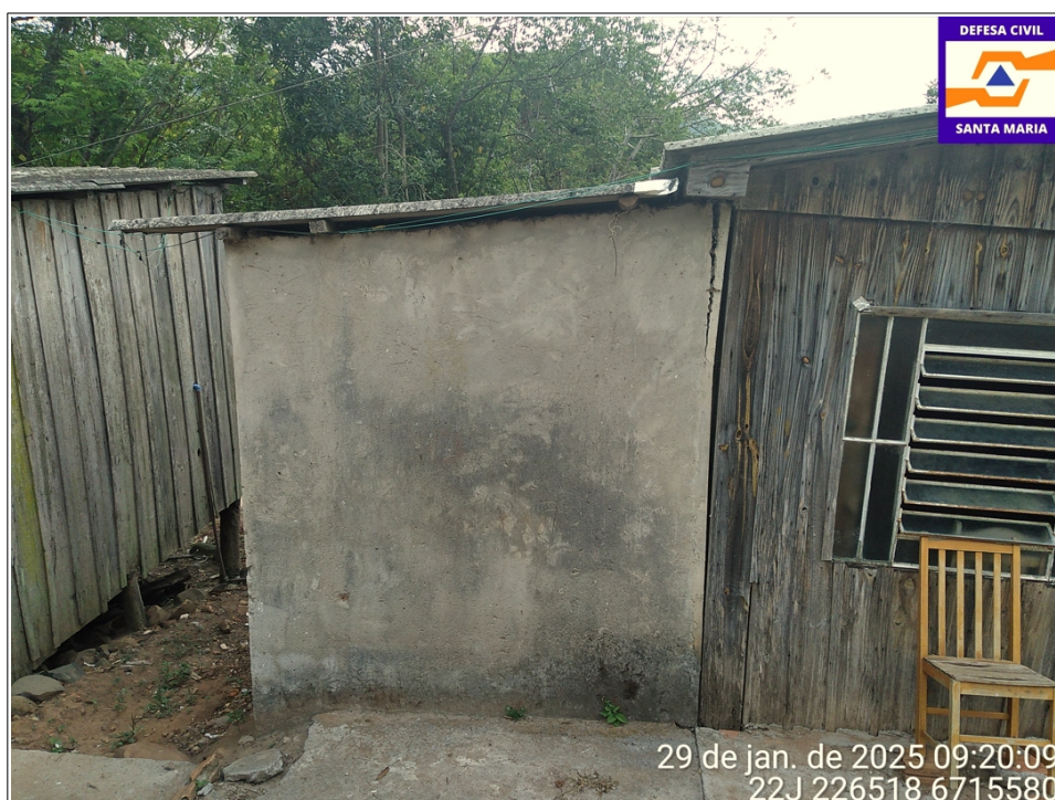
Foto 3: Frente da casa de número 361, em que é possível notar trinca entre a construção de alvenaria e a casa de madeira construída imediatamente a sul. Em relatos de moradores locais houve progressiva abertura da trinca após as chuvas ocorridas em maio de 2024.
