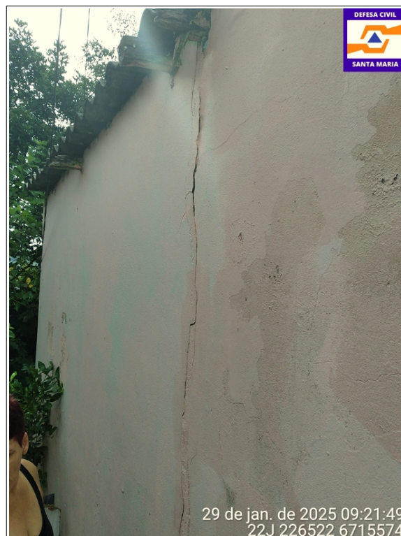
Foto 5: Detalhe para abertura de rachaduras nas paredes da área externa da casa de número 361.
